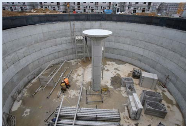
Ansicht in das Innere des Eisspeichers
